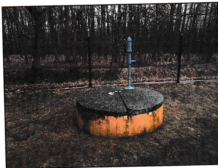
Obr. č. 4 Zdroj vody studna U lesa (hloubka 5,7 m, hladina v úrovni 1,56 m od hrany víka)
