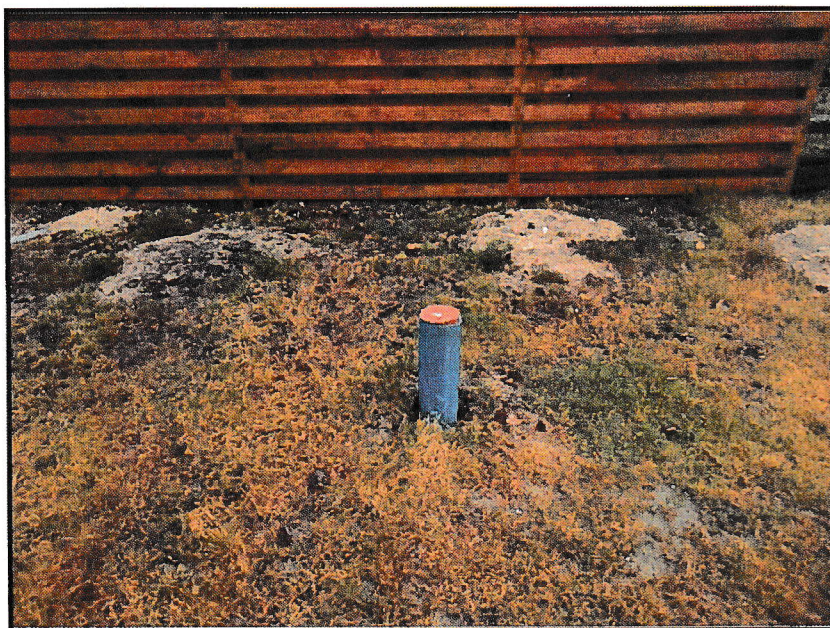
Obr. č. 9 Pohled na nově realizovanou vrtanou studnu u chaty e. č. E86 (hloubka 23 m, stav hladiny 1,68 m pod terénem)
